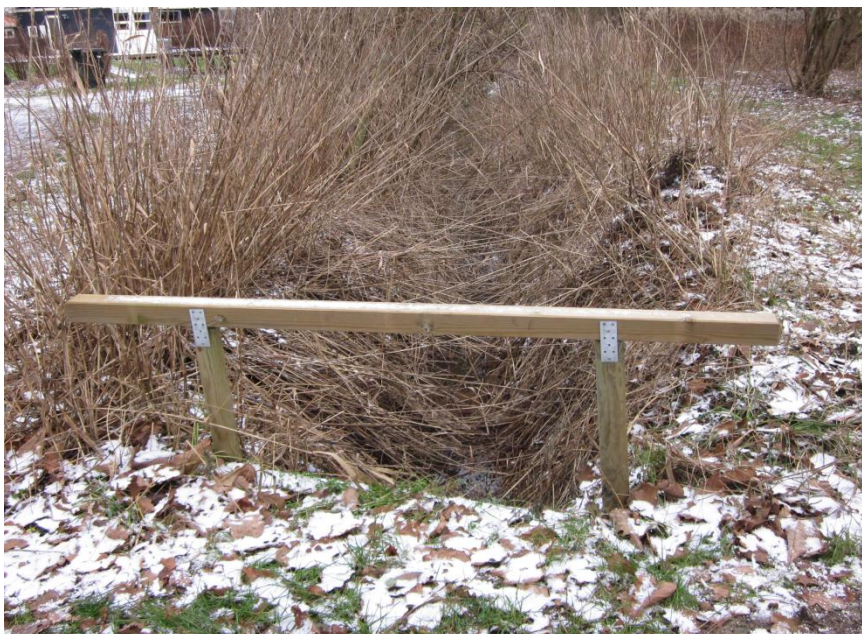
Figur 3: Grøft langs Birkeager set fra tilstoppet overkørsel
